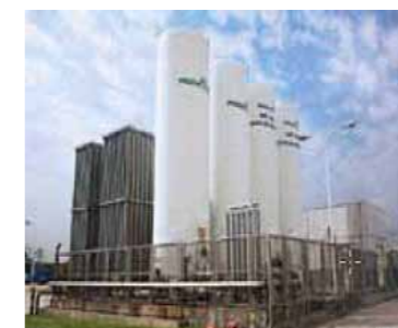
图9. 空气产品公司的商用液体使用可靠且安全的液体储罐和汽化器进行供应。
